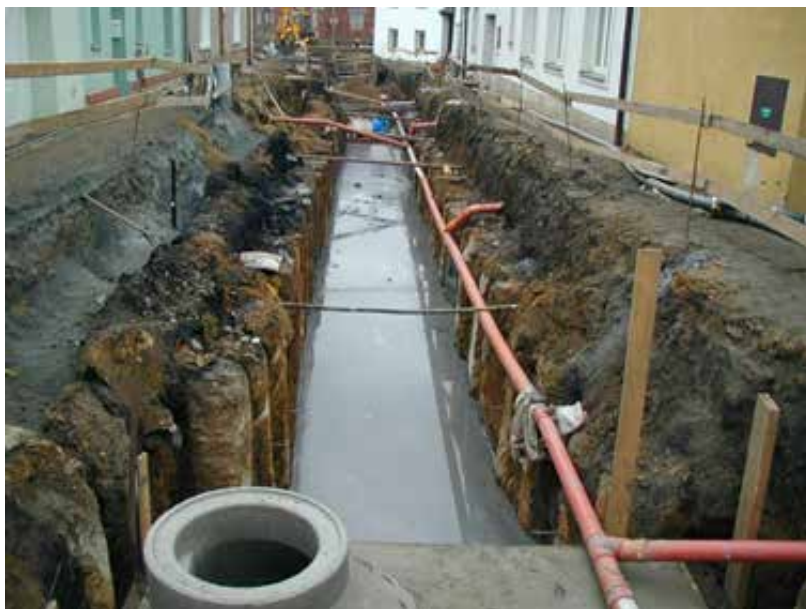
Obr.: 22 Potrubí zalité CPS
